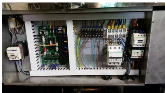
Boîtier électrique avec relais de puissance et disjoncteur
